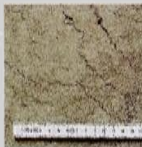
Neprihvatljiva oštećenja (pukotine)
